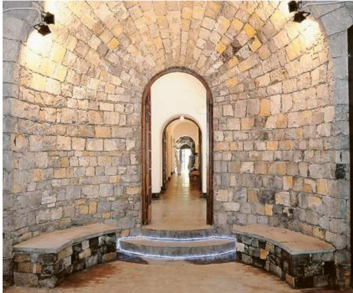
L'ingresso del Covo di Nord-Est con la volta in pietra, valorizzata dai lavori di manutenzione (Fotoservizio Piumetti)
